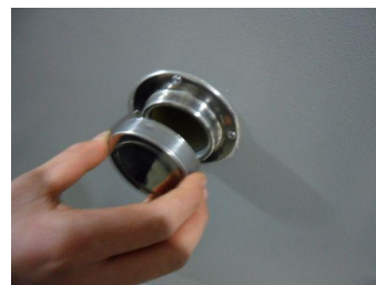
测试孔遮盖物（不锈钢盖）
